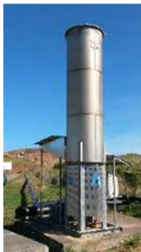
Figure 10 : Vue de la torchère
