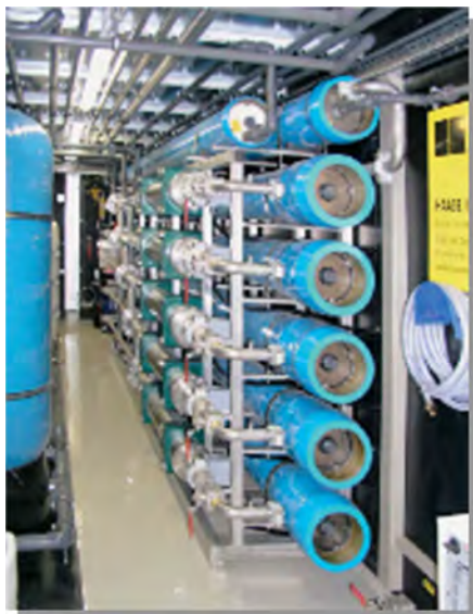
Figure 11 : Vue osmose inverse
