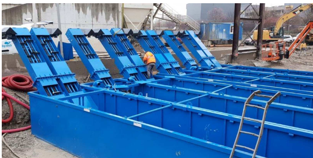
Figure 7 : Photo des bacs de recirculation des boues équipés de racleur
