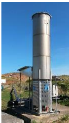
Figure 10 : Vue de la torchère
