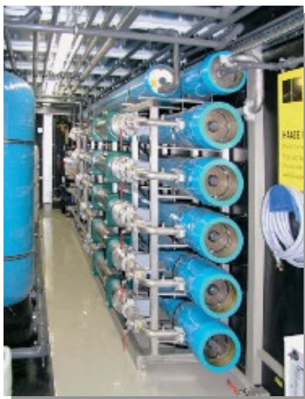
Figure 11 : Vue osmose inverse
