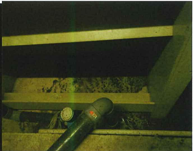
Photo 2 : Débordement de boues sous le décanteur lamellaires
