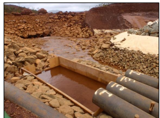
By-pass vers le décanteur aval
