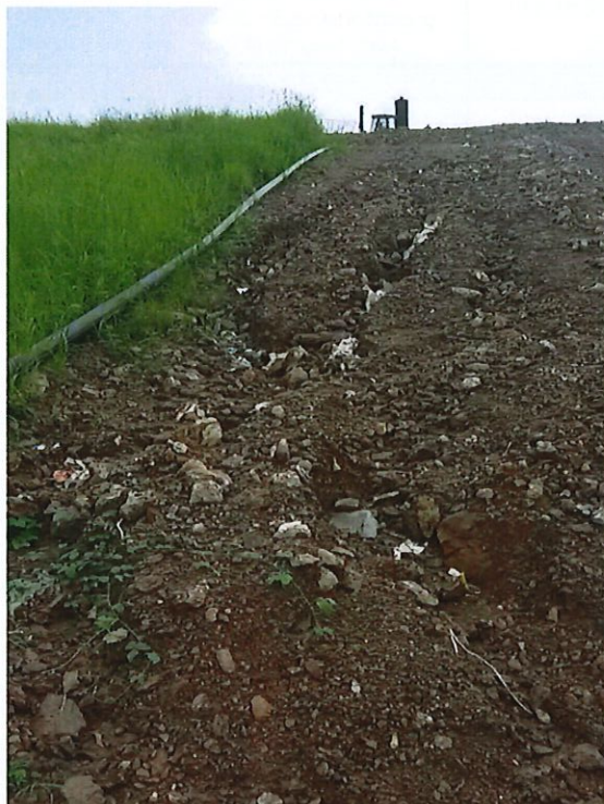
PHOTO 5 – Ravines apparues sur la couverture provisoire des casiers C et D
