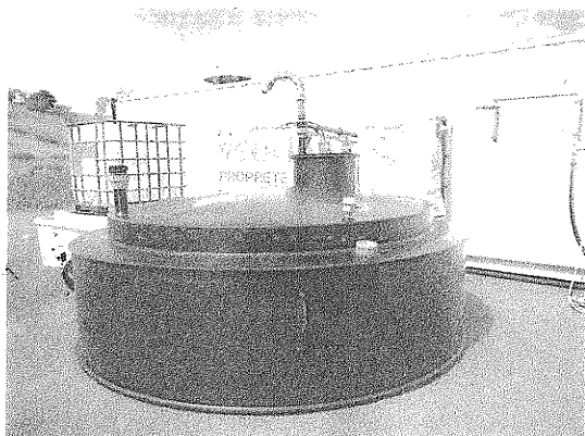
Station de traitement par osmose inverse
