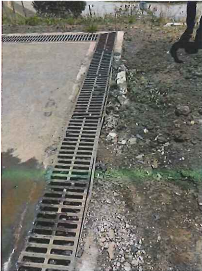
Photo 34 : Caniveau de récupération des eaux de ruissellement de la plateforme draingom dont les bordures béton sont à réfectionner
