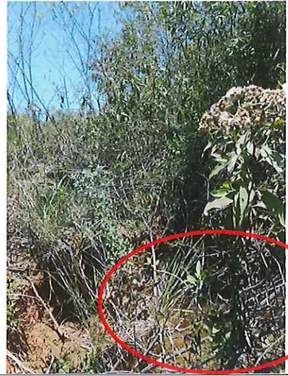
Photo 39 : Zone de résurgence d'eau située entre la sortie du bassin des eaux de pluie et le caniveau de la RM 22 mais en aval du potager
