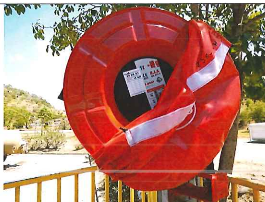
Photo 4 : RIA à l'entrée de la déchetterie
