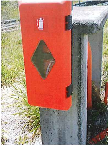
Photo 9 : Extincteur de la torchère
