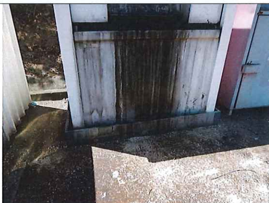
Photo 31 : Benne de récupération des huiles usagées avec huiles ayant coulées sur la paroi et au sol
