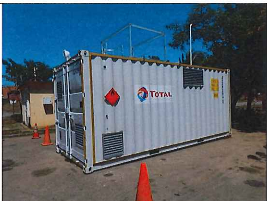
Photo 28 : Container contenant la cuve de stockage et la distribution du gasoil
