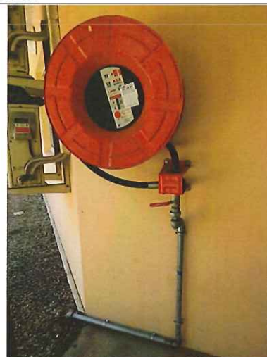
Photo 2 : un des RIA des locaux administratifs
