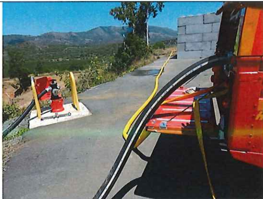
Photo 11 : Raccordement du VPI à la borne de la plateforme draingom
