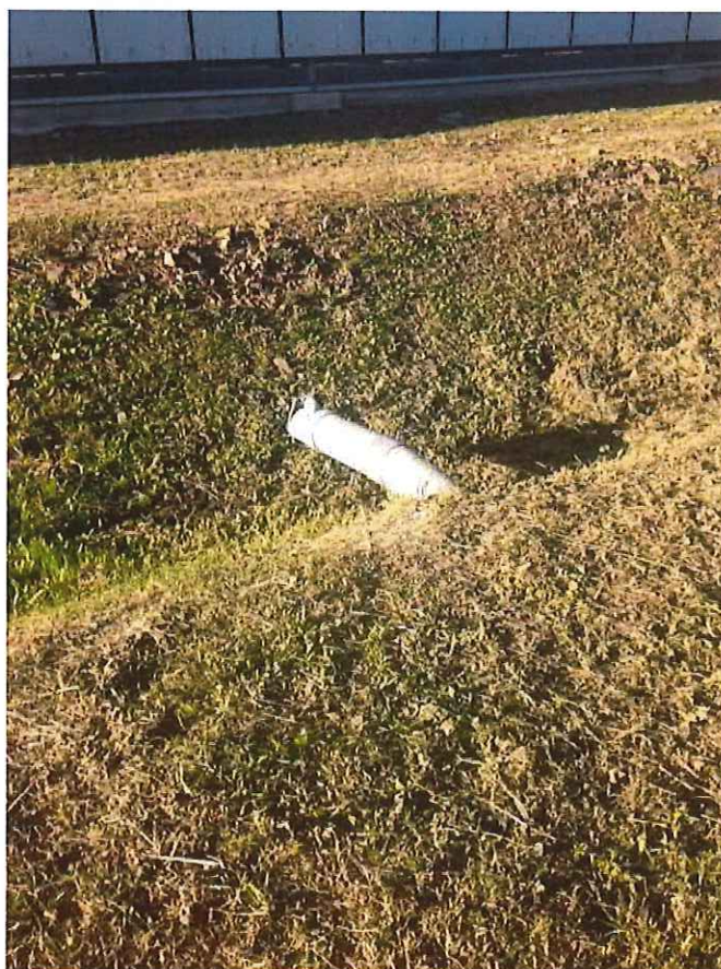
Point de rejet des eaux de lavage des poussinières dans le milieu naturel
