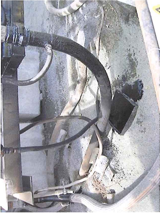
Photo 9 : Ecoulement de bitume au droit de la centrale d'enrobage à chaud (système temporaire de récupération)
