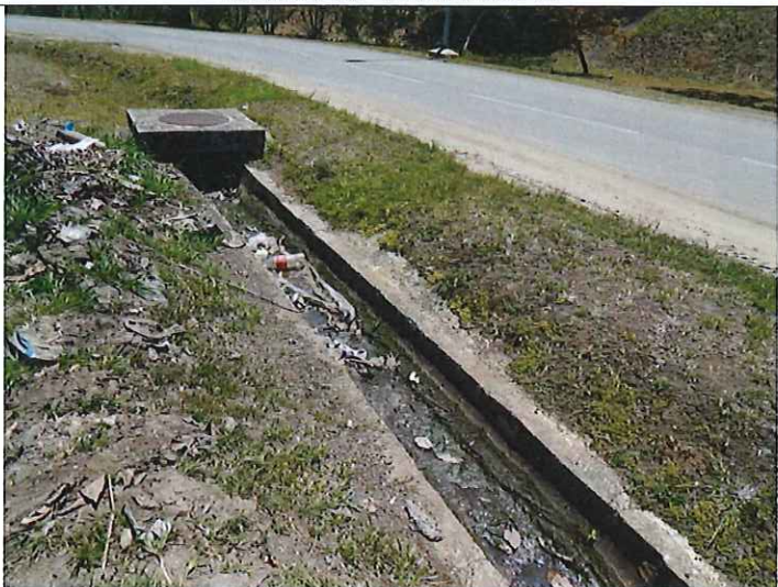
Photo 7 : Caniveau de récupération des eaux de pluie à curer
