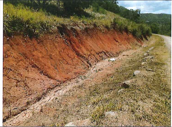
Photo 16 : Fossé en contrebas du point de rejet des eaux des bassins d'eaux pluviales au niveau de la route RM 22
