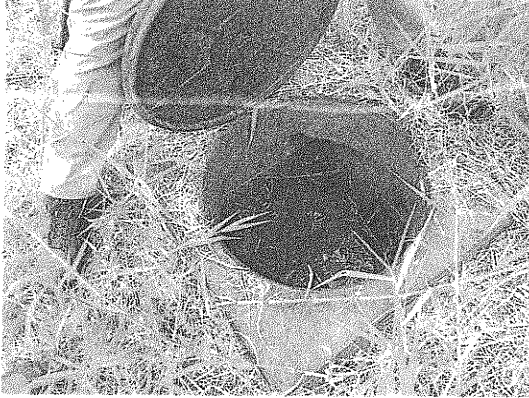
Cuve de récupération des lixiviats du CET à vidanger
