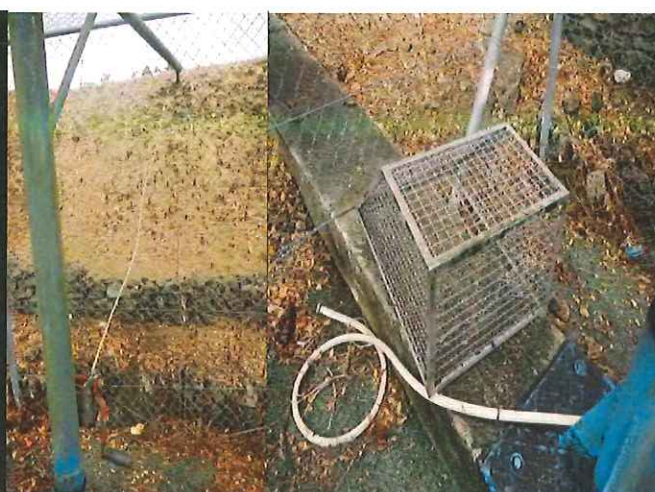
Panier de dégrillage (à droite) et sa poulie de maintien (gauche)
