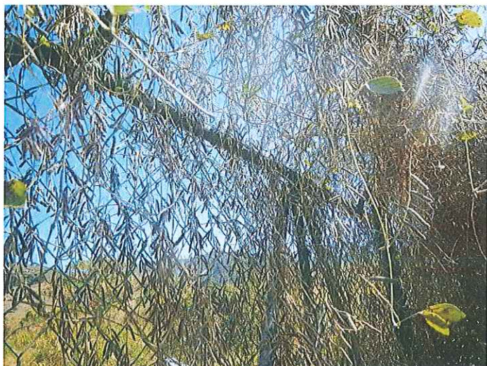
Portail d'accès envahi par la végétation
