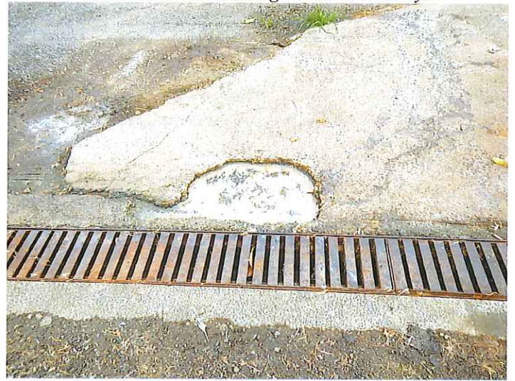
Zone de stagnation d'eaux issues de l'abattoir dégageant une odeur nauséabonde à évacuer et zone de la dalle à réfectionner
