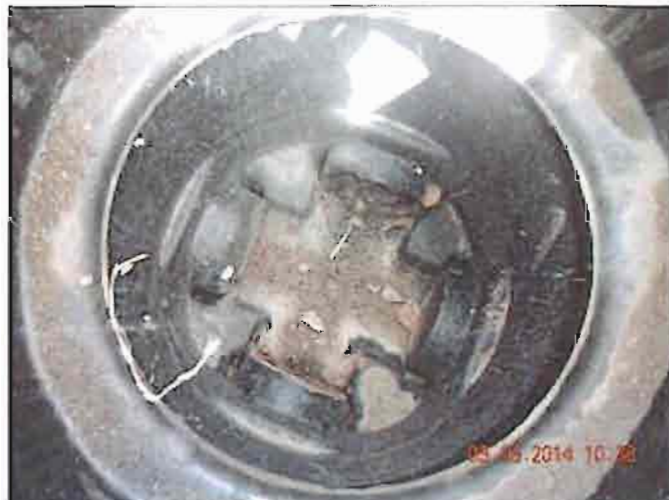
Regard de visite du système d'assainissement
