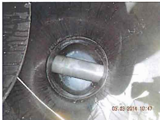
Sortie du séparateur hydrocarbure
