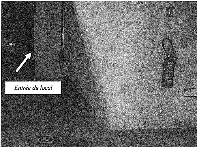
Extincteur non visible depuis l'entrée du local
