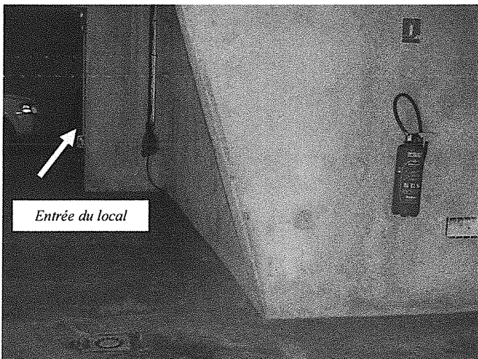
Extincteur non visible depuis l'entrée du local
