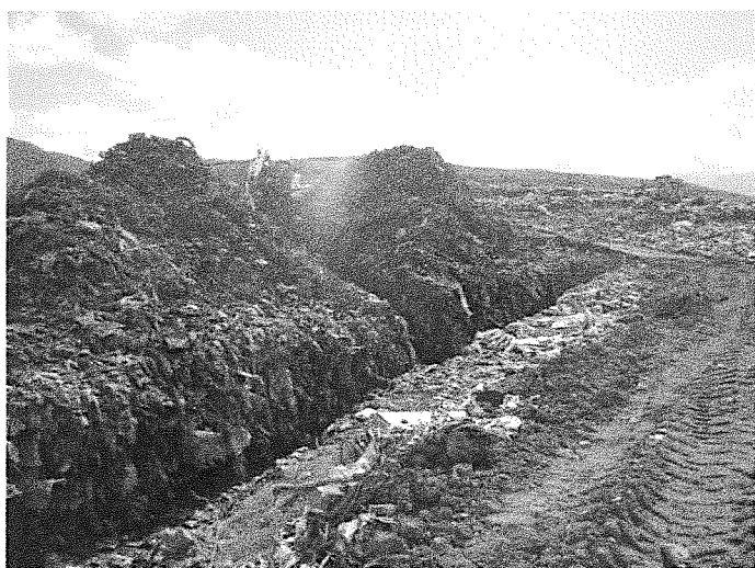
Tranchées d'infiltration des condensats provenant du traitement des lixiviats et déchets à évacuer
