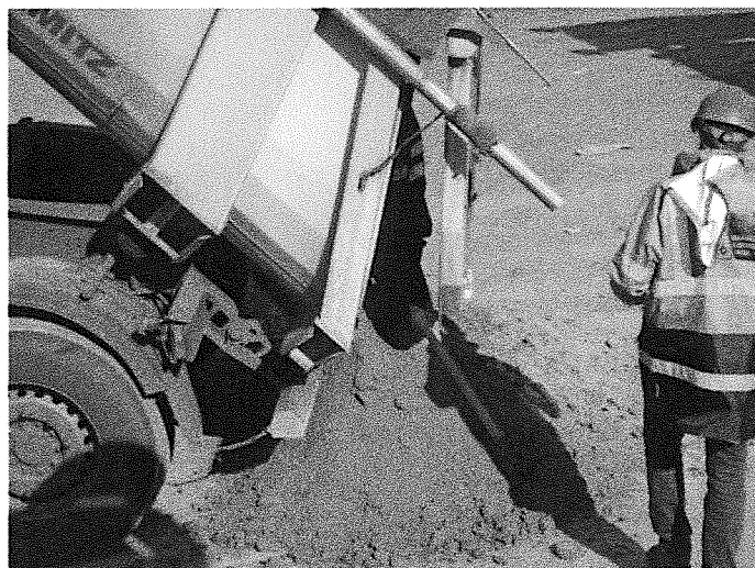
Déchargement du camion cendrier (opérateur présent entre la benne et la porte de benne, sans EPI adapté)
