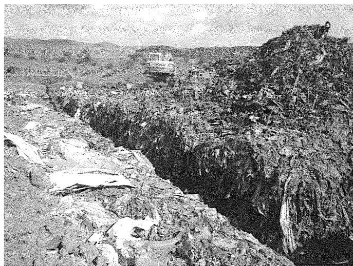
Tranchées d'infiltration des condensats provenant du traitement des lixiviats et déchets à évacuer
