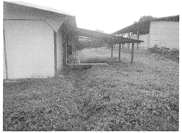
Figure 8 - Caniveau entourant un poulailler obstrué par les végétaux
