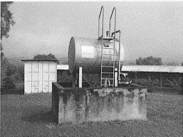
Figure 5 - Cuve de stockage aérien de gasoil
