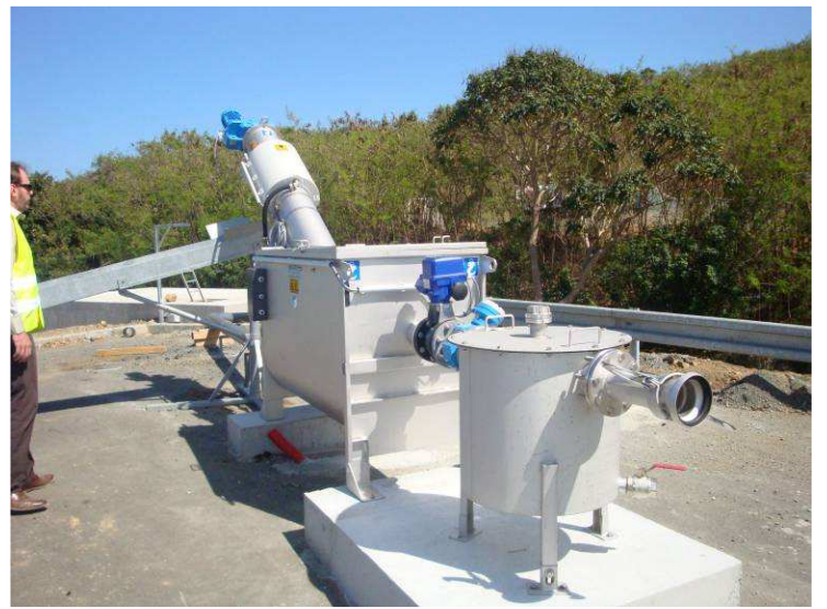
Photo 10 : dégrilleur de la nouvelle installation de traitement des déchets liquides biodégradables
