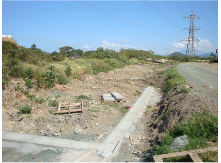
Photos 2 : caniveaux, en cours d'installation, permettant la récupération des eaux de la plateforme de séchage des boues
