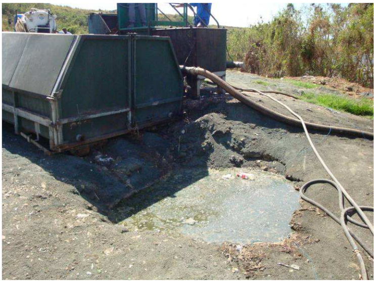
Photo 9 : trou de récupération des eaux provenant de la benne dédiée aux déchets du dégrilleur
