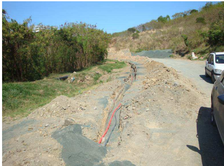
Photos 4 : réseau électrique pour alimenter la pompe de relevage immergée dans la cuve
