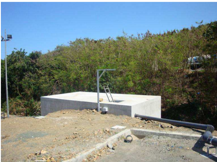
Photo 11 : cuve tampon de la nouvelle installation de traitement des déchets liquides biodégradables
