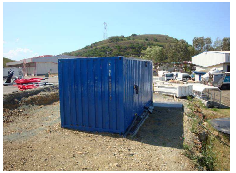
Photo 12 : Equipement de traitement physico-chimique des déchets liquides biodégradables
