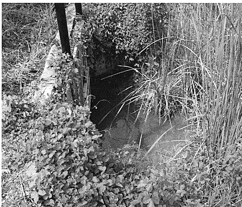
Eaux en tête des vannes guillotines après pompage des lixiviats (cliché pris le 18/04)
