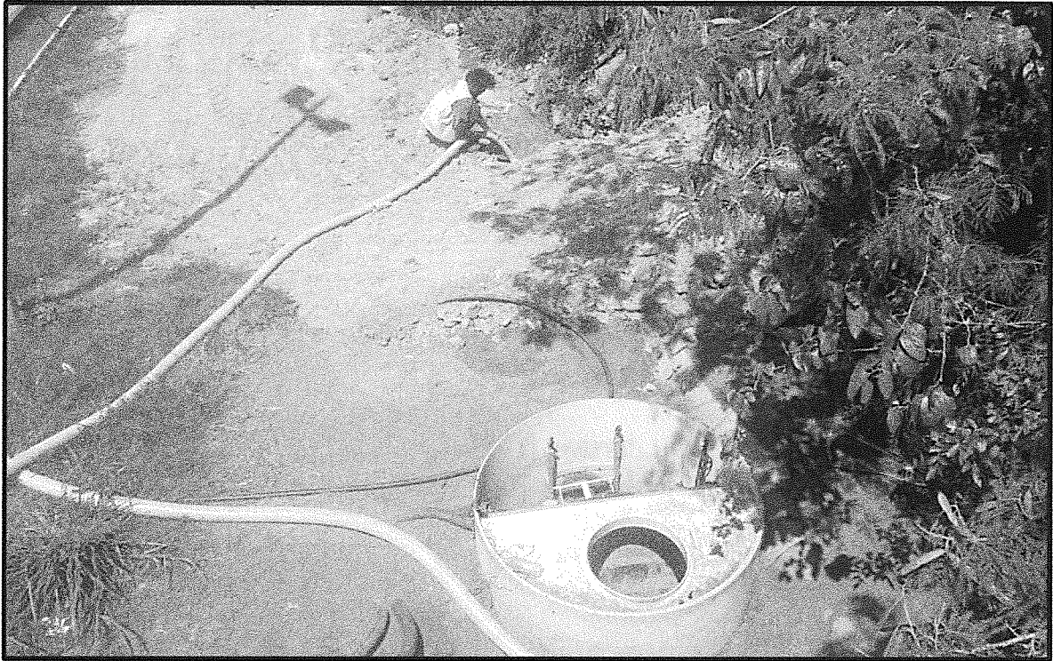
Photo 3 - Intervention d'un vidangeur pour atténuer l'impact environnemental du débordement
