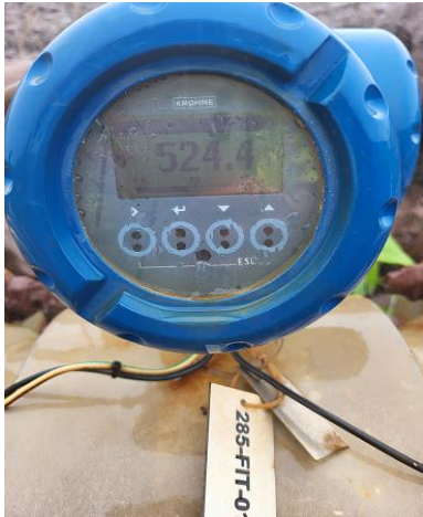
Débit pump pit vers KO2 - PPM11 et 13 + PPP-021
