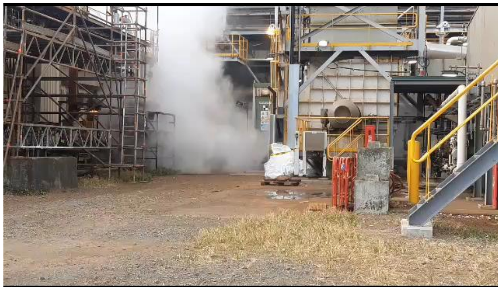
Vidéo de la fuite vapeur du FIT-60009
