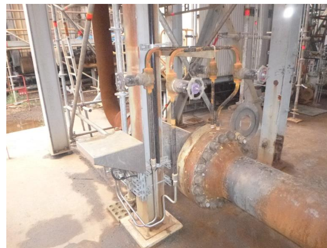
Emplacement du FIT-60009
