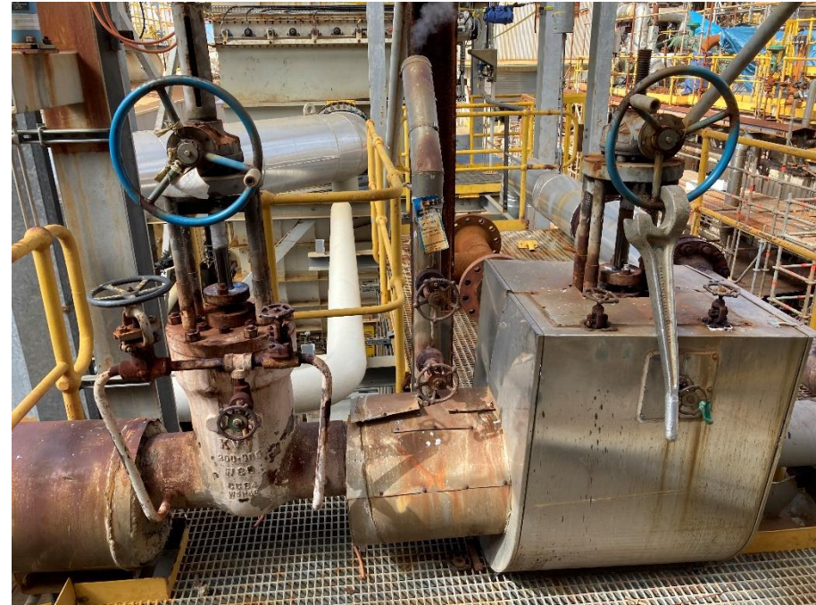
Vanne d'isolation export vapeur
