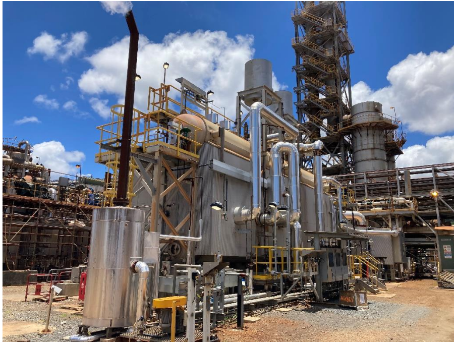
Vue Générale de la chaudière 4
