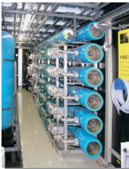
Figure 10 : Vue osmose inverse
