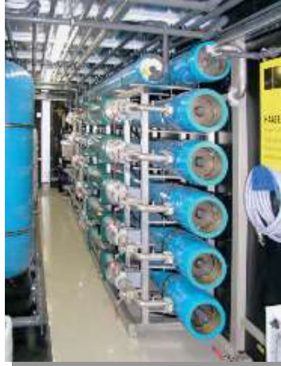
Figure 11 : Vue osmose inverse
