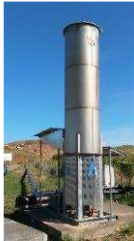
Figure 10 : Vue de la torchère
