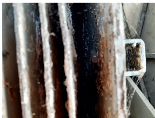
Anneaux de séparation manquants
